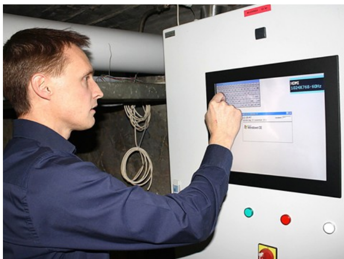
Koen Verschuere, zaakvoerder van FixSus, bedient de software van de HVAC-installatie. Het concept werd door het bedrijf uit Ertvelde ontwikkeld
