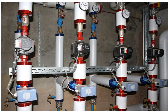
Vier van de acht secundaire kringen van de stookinstallatie van het MPI Landegem, ontworpen door FixSus
